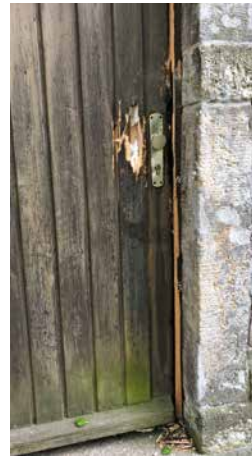
Vor der Reparatur
